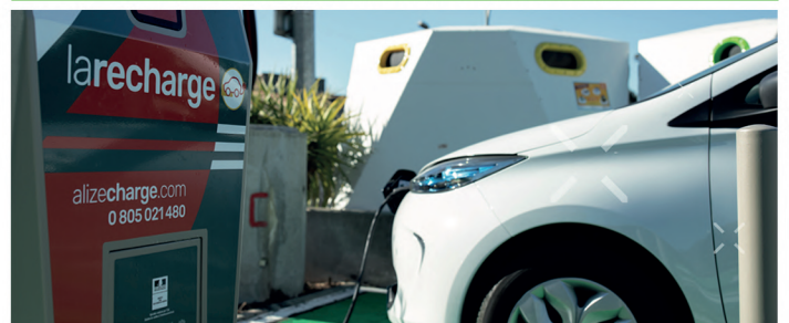
BORNE DE RECHARGE PUBLIQUE DE VÉHICULES ÉLECTRIQUES
